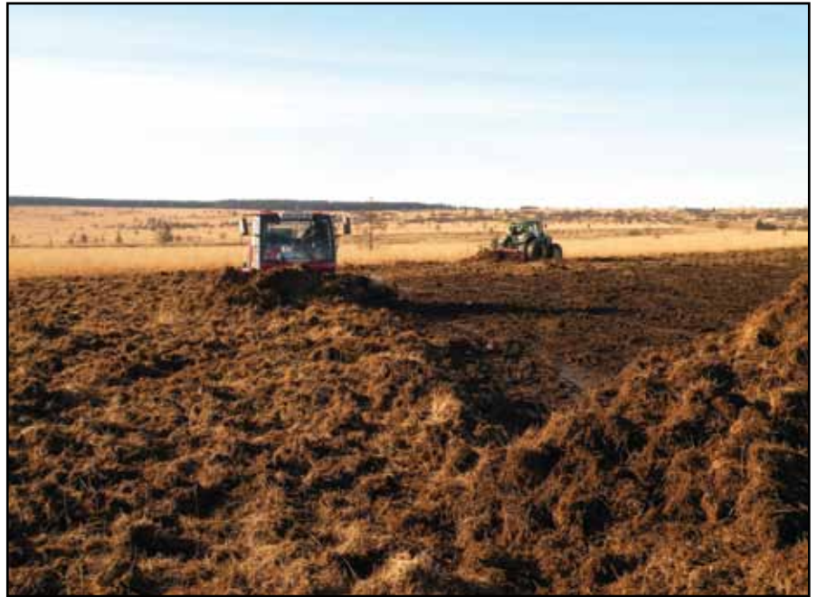
Travaux de fraissage en Haute Fange grâce à un matériel bien adapté. (Photo LIFE).
