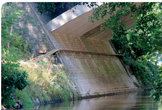
Loutroduct sous la nationale 4 à Tenneville @ Vinciane Schockert
