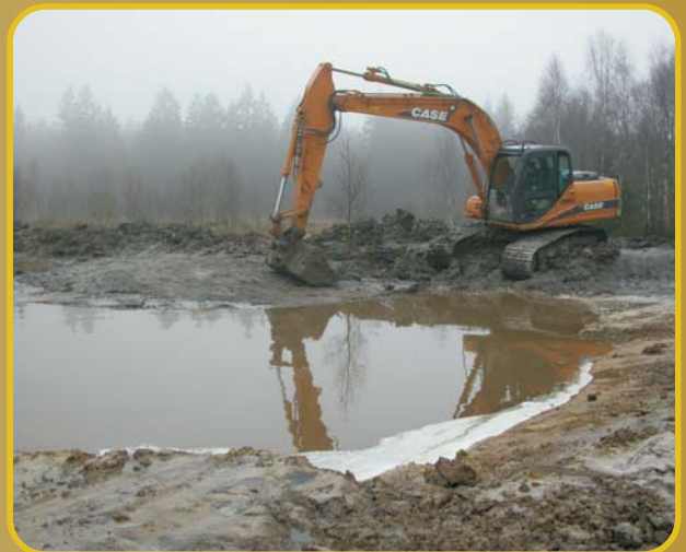
Mare creusée dans une coupe à blanc sur un haut-plateau ardennais. Les argiles ont été étalées autour de la mare et ont contribué à former une digue. Les berges sont adoucies à l'aide de la pelleuse. Cliché Philippe Goffart
